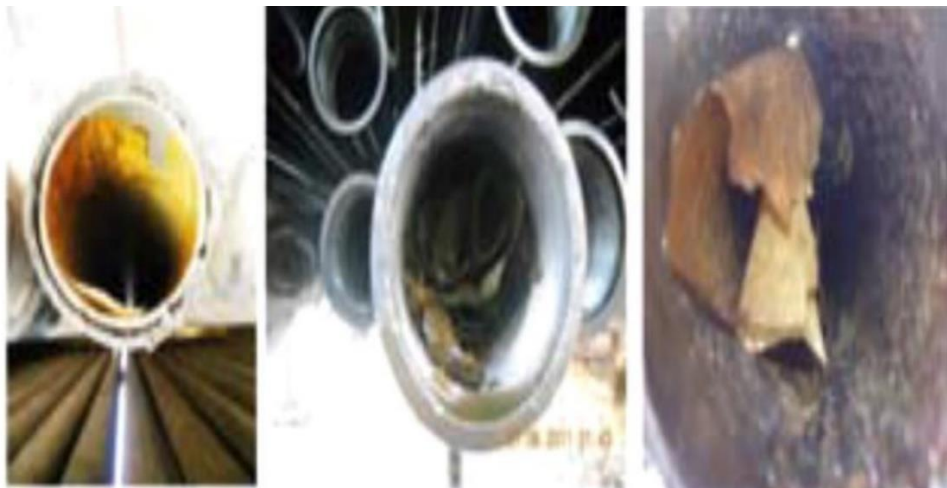
Рисунок 12 - Отслаивание полиуретанового покрытия «PolyPlex-P» [96]
