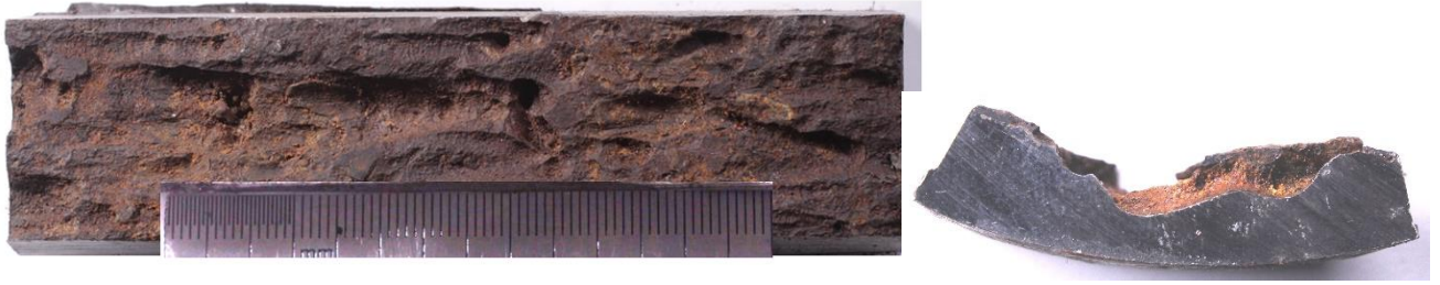
Рисунок 3.5 – Характерный вид внутренней поверхности трубы из стали 09Г2С после 2 лет ОПИ.
